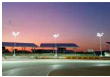
Neue Flutlichtanlage Seite 3
